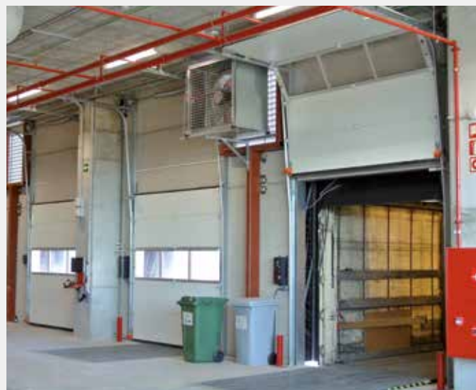
Rampa HIDRA y puerta seccional. Vista interior.
