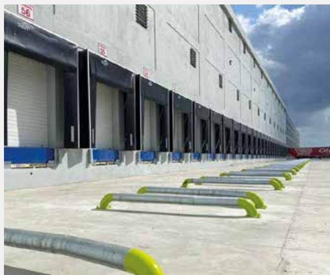
Rampa Hidra, abrigo de muelle AB y puertas enrollables en República Dominicana
