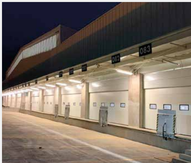
Muelle de carga con pasarelas de aluminio .
