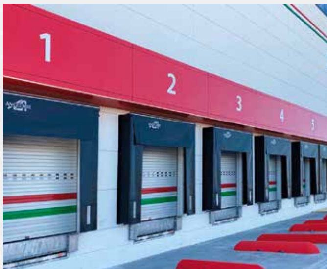
Rampa Hidra con puertas enrollables con mirillas.
