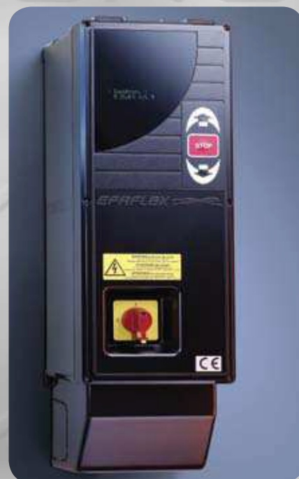
Cuadro de control.
